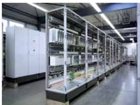
Bild 2: Nutzenpotentiale im Schaltschrankbau – Betrachtungsgegenstand im Seminar mit der Weidmüller Interface GmbH
